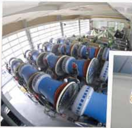
Schneekanonenlager K1 Schlegelkopf (=Kompressorstation)
